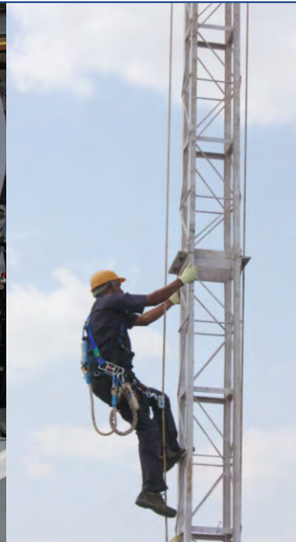
Met Mast Instrumentation of Xyron 1000 kW WT
